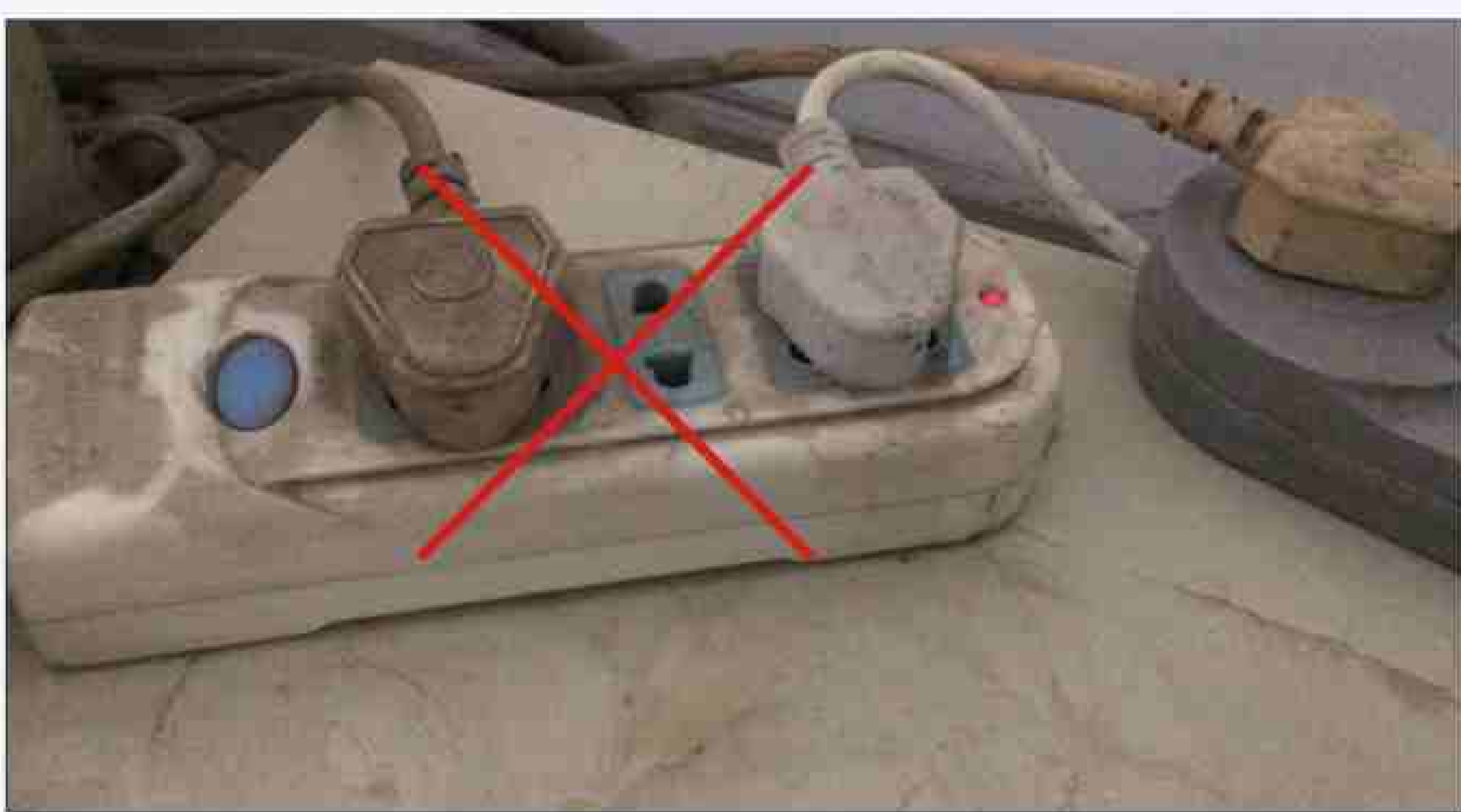
严禁超负荷用电
